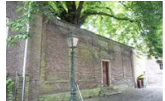
Figuur 6. 2023 Kastanjeboom en de muur met schade. 7
