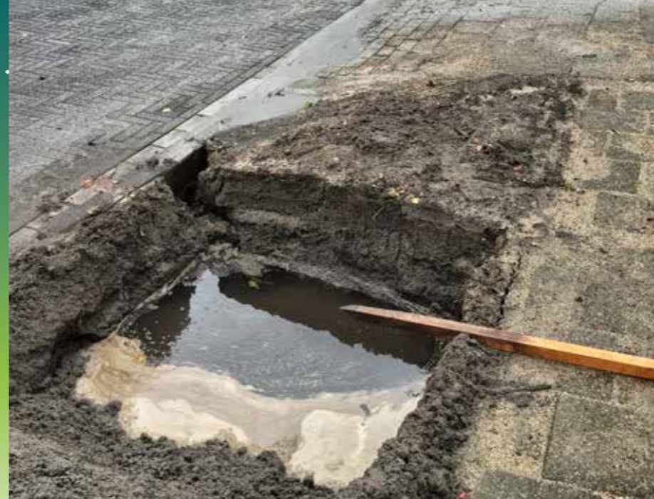
Het planten van bomen in ongeschikte plantplaatsen is zinloos. Hier watert het wegdek af naar de plantplaats met een ondoordringbare bodemlaag: iedere boom zal uiteindelijk 'verdrinken'.
